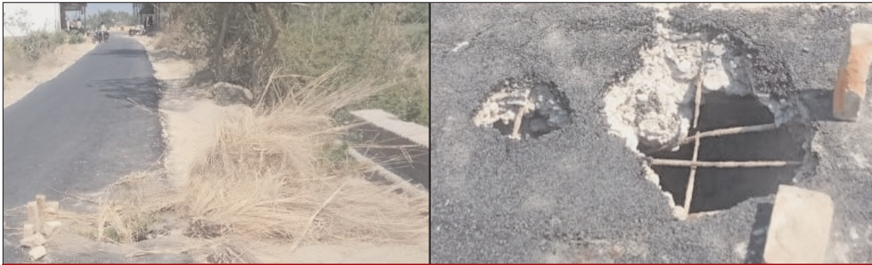
योगीजी देविए पीडब्लूडी प्रांतीय खंड वाले आप के जीरो टालरेंस की धिज्जया उड़ा रहें। लगभग 69 लाख की सड़क अगर 24 घंटा भी नहीं चलेगी तो फिर सड़क पर पैसा खर्च करने से क्या फायदा। विकास खंड कुदरहा के राम जानकी मार्ग चकदहा से सुअरहा तक 5700 मी. सड़क का मामला। यह उस विभाग के सड़क का सच है, जिसके मानक पर जिले भर में निर्माण कार्य होता
